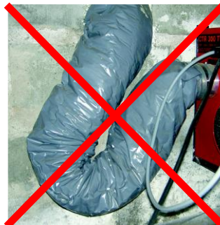
Nieprawidłowy montaż, mocne zgięcie
