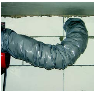
Korrekt montering, svak bøy.
